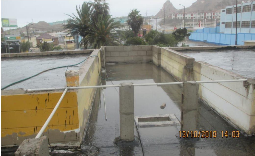
Agua acumulada en techo de C.S. Marcona
