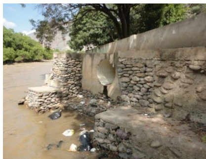
Fotografía N° 2 – Punto de vertimiento del Hospital Regional Hermilio Valdizán Medrano
