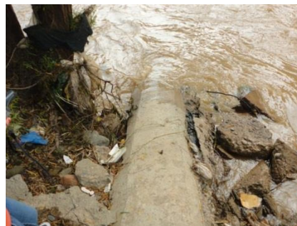
Fotografía N° 1 – Vertimiento en el Jirón Circunvalación, con desembocadura debajo del espejo de agua por época de avenida
