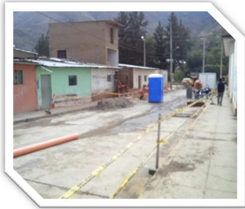
Fotografía N° 07. Ausencia de maquinarias utilizadas en la obra
