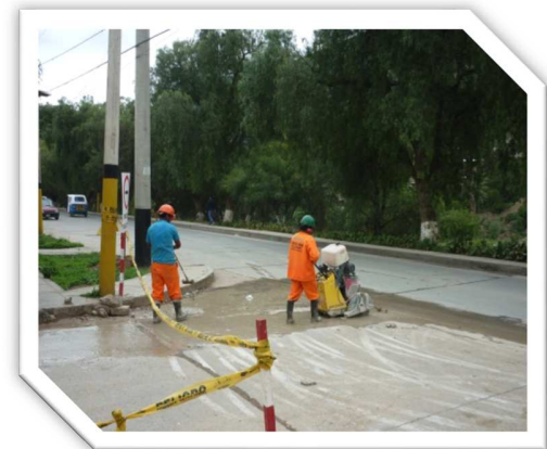
Fotografía N° 04. Cortadora de concreto produce ruidos molestos.
