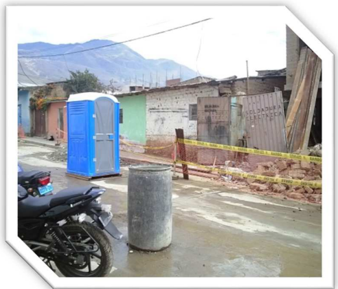
Fotografía N° 07. Implementación de baños portátiles
