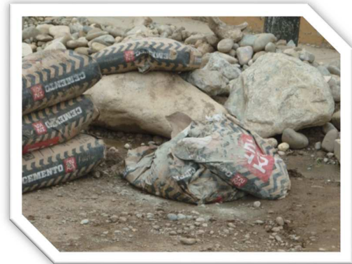
Fotografía N° 03. Bolsas de cementos dispersos y rotos
