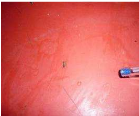
Presencia de excremento de roedores
